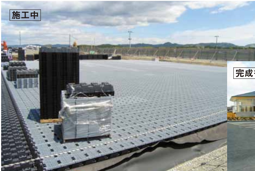
宮城県内庁舎調整池 (貯水量: 1,700m³)
