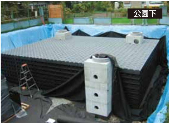
東京都内雨水利用貯水槽 (貯水量: 100m³)
